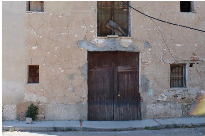
Fig. 24: El deteriorament en la façana principal ha estat evient els últims anys [Fotografia], 2021, Arxiu del CEL.
