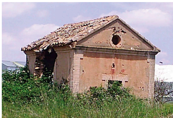
Fig. 7: Progressiu deteriorament del baixador del tren en la masia d'Escoto, 2007. Actualment, el deteriorament és més accentuat.
